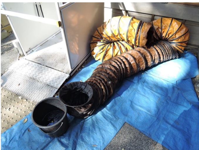
作業で真っ黒になったフレキシブルダクト
